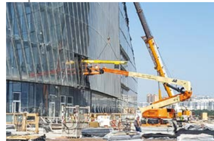
Notre traverse à contrepoids développée sur mesure en service
